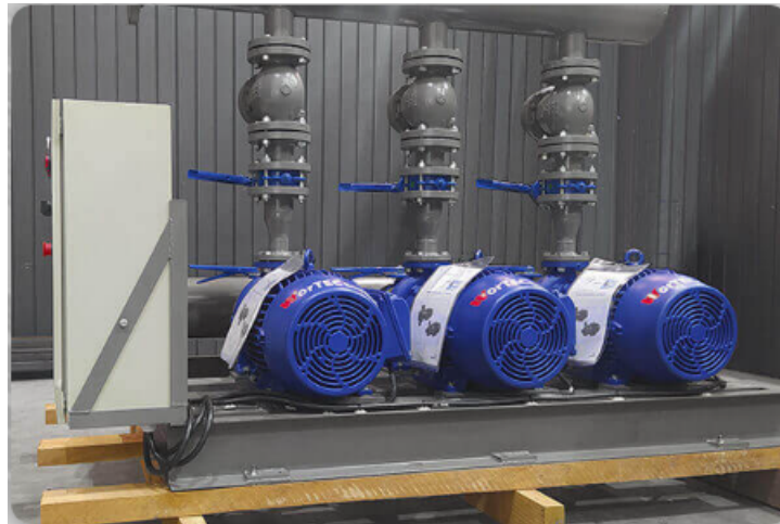
Figura 3: Exemplo de skid de bombas.
