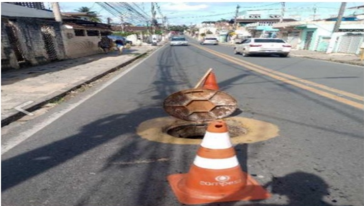
Imagem 4 –poço de visita da interligação
